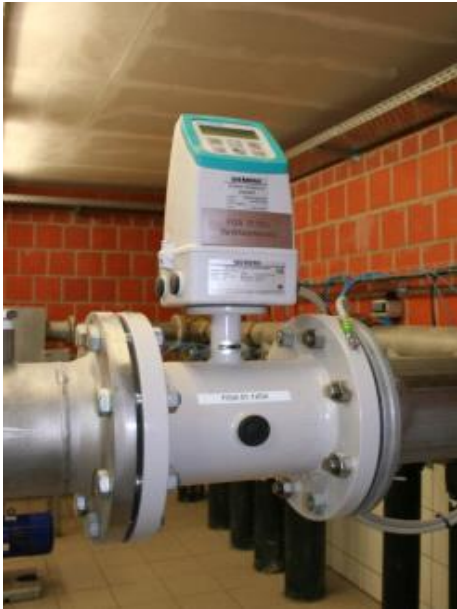
Magnetisch-Induktive Durchflussmessung (Fa. Siemens)
